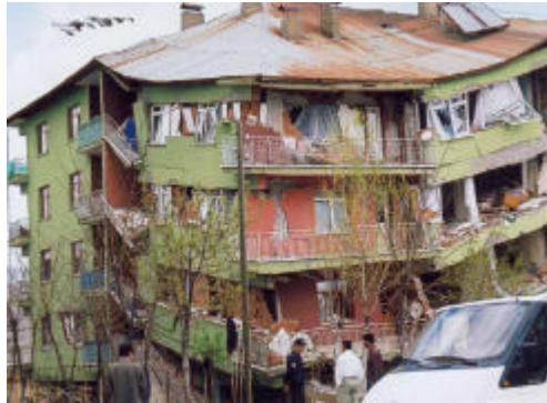
Zemin kat kolonları çökmüş Arif Gelin apartmanı
