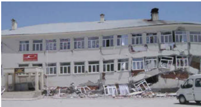
Kaleönü İlköğretim okulunda (zemin+2 kat) zemin kat çökmüştür. (zemin kat diğer katlardan 1 m daha yüksek+yetersiz beton dayanımı +kolondan kolona pencere boşlukları+fazla pencere sayısı nedenleri ile yetersiz düktilite sözkonusu)
