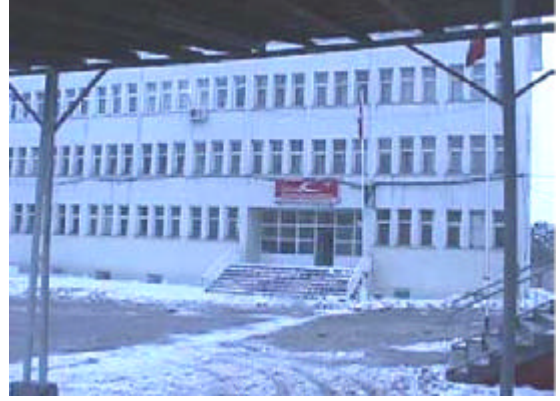
Valilik binasi -ilçe merkezindeki en hasarlı bina- (Yetersiz detaylar ve çok düşük beton kalitesi !)
