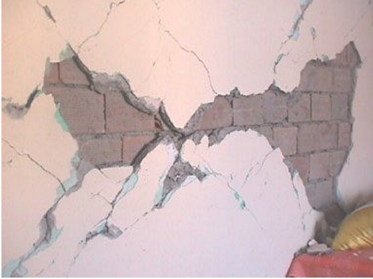
Bosluklu tuğla ile yapılmış klasik bir ara duvarda kayma çatlakları
