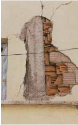
Çerçeve duvar ayrışması ve kolon hasarı
